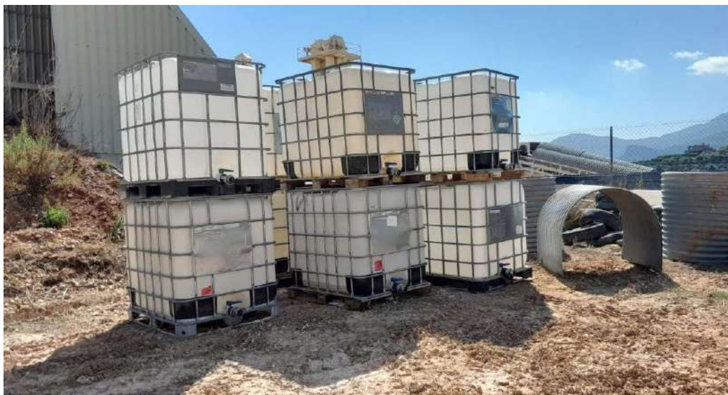
Ilustración 4: Nuevos depósitos de agua de 1 m 3 cada uno
