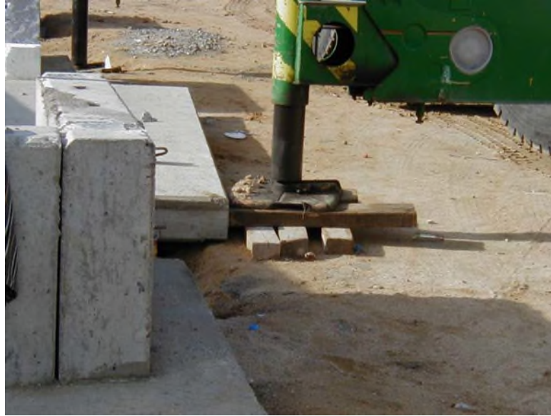
Buen apoyo de la grúa en el suelo. Uso de tablonces de madera
