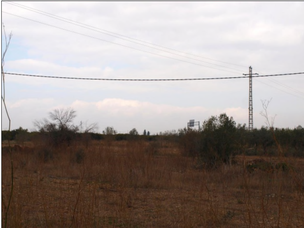
Fotos 4 y 5. Tramo inicial de la fase 1 de la línea eléctrica (apoyos 1 y 2) en la salida de la ST Boveral y giro hacia la carretera N-340, que se puede ver al fondo.
