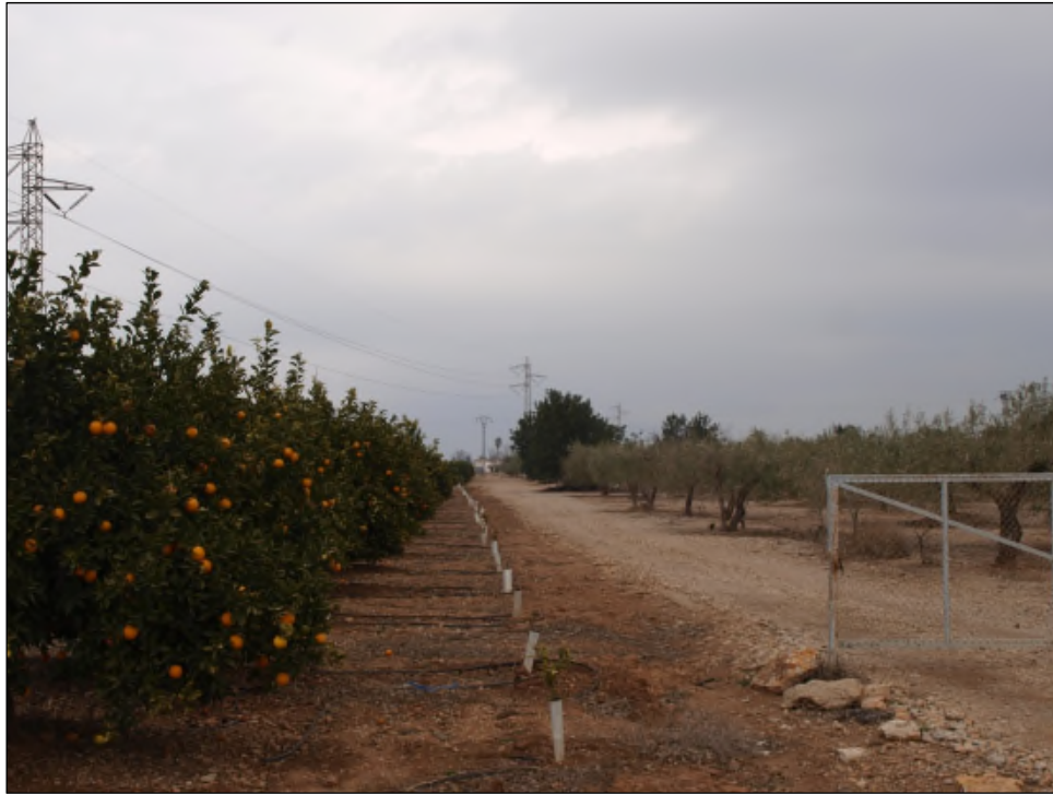
Foto 9. Tramo de la L/66 kV Benicarló-Cemenmar 2 afectado por las nuevas líneas. El apoyo que se ve en la parte central de la imagen es el apoyo a sustituir por el nuevo apoyo 5.
