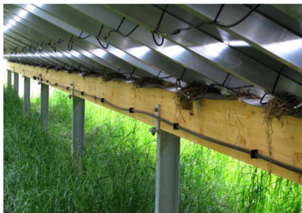
Ilustración 4 Nidos en los soportes de los módulos fotovoltaicos
